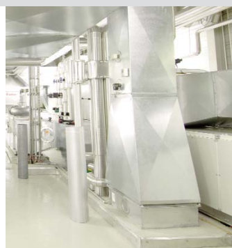
Monitorización de condiciones ambiente en conductos
